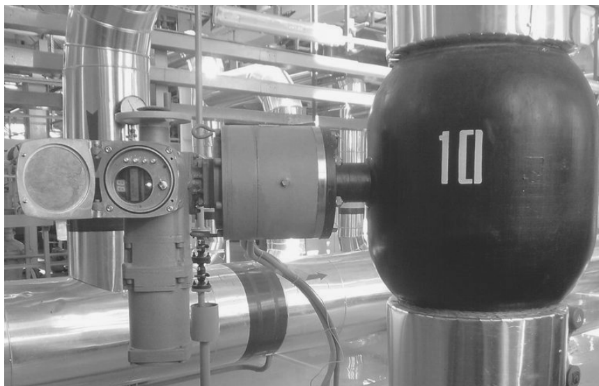
Рисунок 6 – Редуктор и электропривод на шаровом кране.
